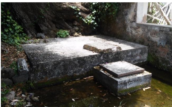
a) Caja de captación donde brota el manantial
