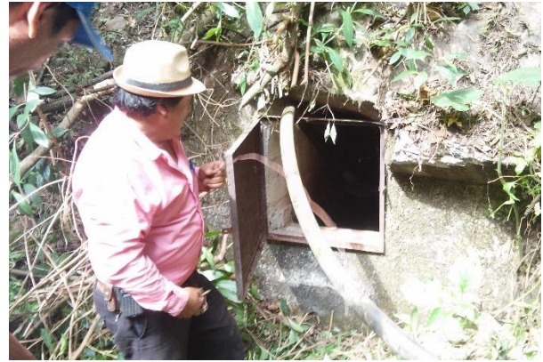
b) Cajas de captación de los veneros
