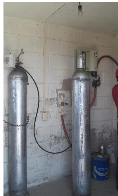
d) Tanques de cloración
