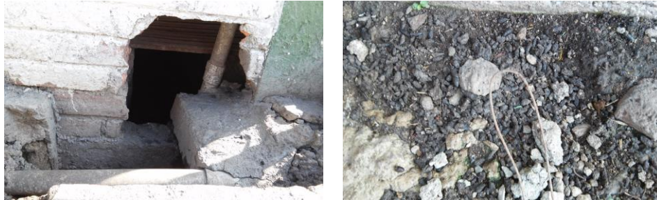
Figura 24. Daños de la infraestructura
