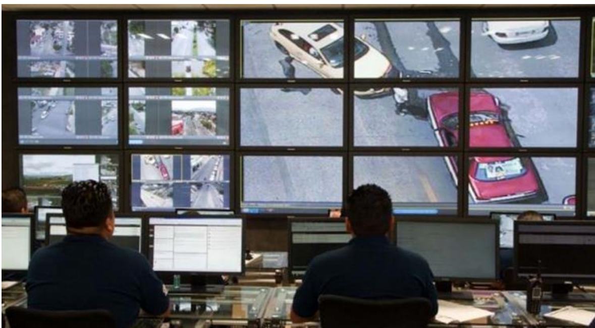
Ilustración 20 Imagen actual del Centro Computarizado de Control Vial "Sistema SCAT" de la Ciudad de México "C2". Fuente: Consultado en: https://meganoticias.mx/tu-ciudad/distrito-federal/noticias/item/157424-apoyan-con-camaras-de-vigilancia-operativo-en-transporte-publico-local.html
