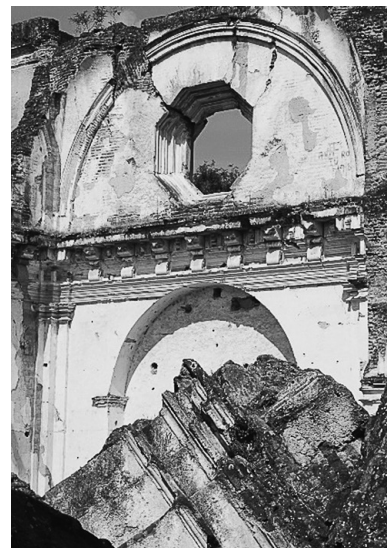
» Imagen 2: Estado de destrucción en muros y presencia de grietas Fotos H. Serrano.
