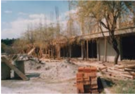
Avances de la construcción del edificio de la Escuela de Antropología (Autor Anónimo. Acervo de la Facultad de Antropología)
