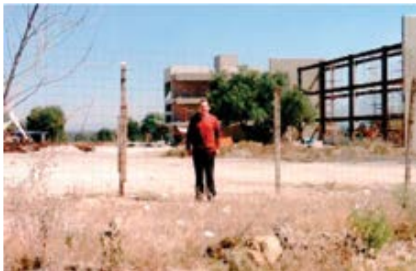
Detalles de la construcción de edificios que albergarían la UAP Acolman. (Autor Anónimo. Acervo de Alberto Salgado Valdés)
