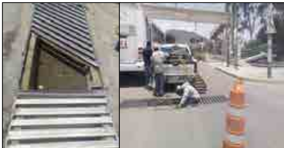
Fotografía 37: Rejillas averiadas frente a las instalaciones universitarias, Campus Los Uribe; UAEM
