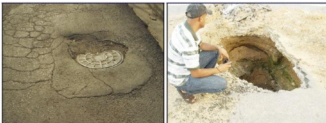
Figura 7. Hundimientos y colapsos de carreteras debido al fenómeno de erosión subterránea, ciudad de Pinar del Río, Cuba Occidental.
