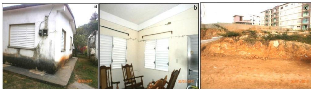
Figura 8. Fenómenos geotécnicos en el tipo ingeniero-geológico aluvial marino fino. Donde, a y b: grietas bien desarrolladas en los muros de la vivienda y c: afloramientos de arcillas en las cercanías de la vivienda.
