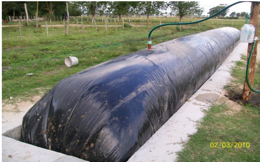
Figura 10. Biodigestor de flujo continuo (Castellanos, 2011).
