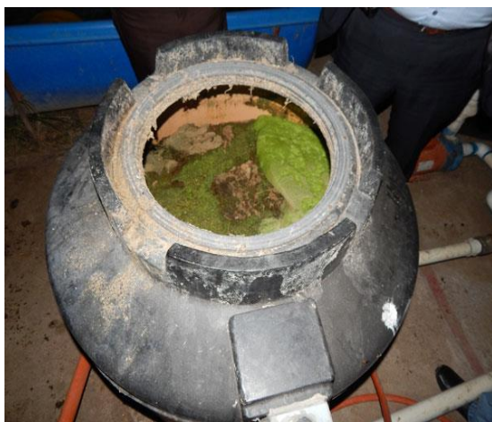
Figura 16. Tanque de homogenización separado Integrado (COFUPRO, 2013)
