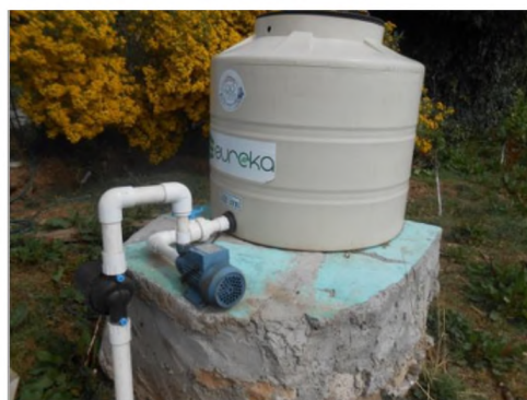
Fotografía 14. Depósito de agua y bomba
