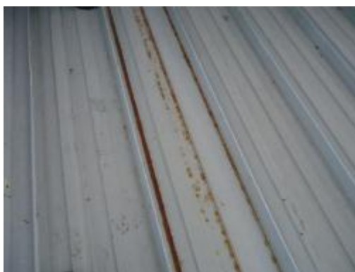
Figura 6.3 Estado de techos de uno de los techos de la empresa en estudio (Elaboración Propia)
