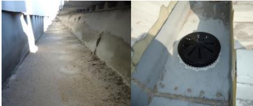
Figura 6.7 Izquierda, Infraestructura de Empresa en estudio. Derecha drenaje sifónico, instalación en obra de remodelación de Laboratorio México, DF (Elaboración propia).
