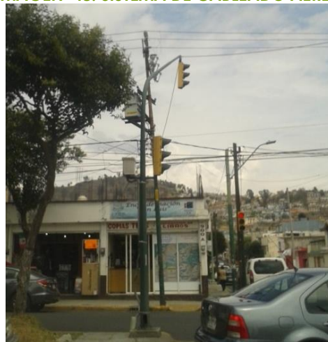
IMAGEN 48. SISTEMA DE CABLEADO AÉREO
