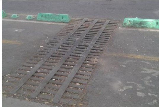
IMAGEN 47. ESTADO ACTUAL DE LAS ALCANTARILLAS DE LA CALLE
