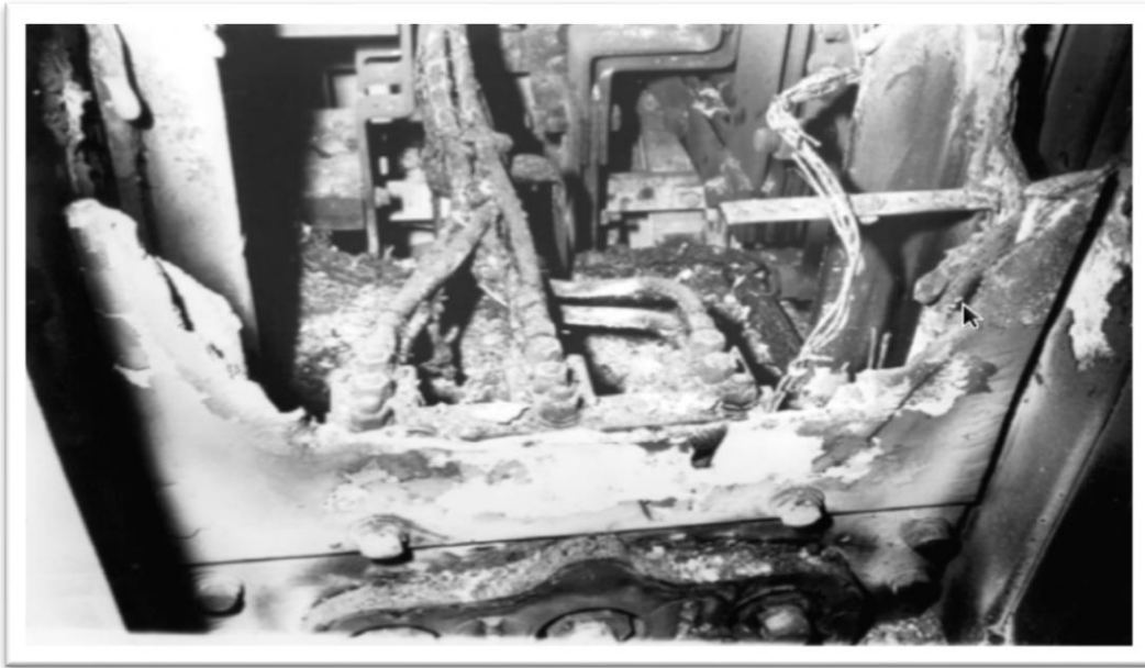
Figura 1. Daños causados por arco eléctrico a bordo del USS Parche (SSN 683)
