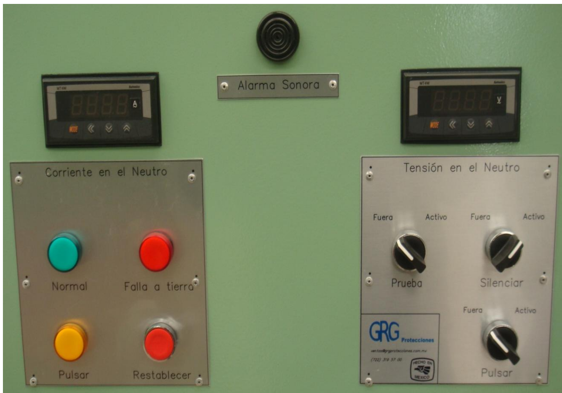
Figura 25. Elementos externos de tablero de falla a tierra
