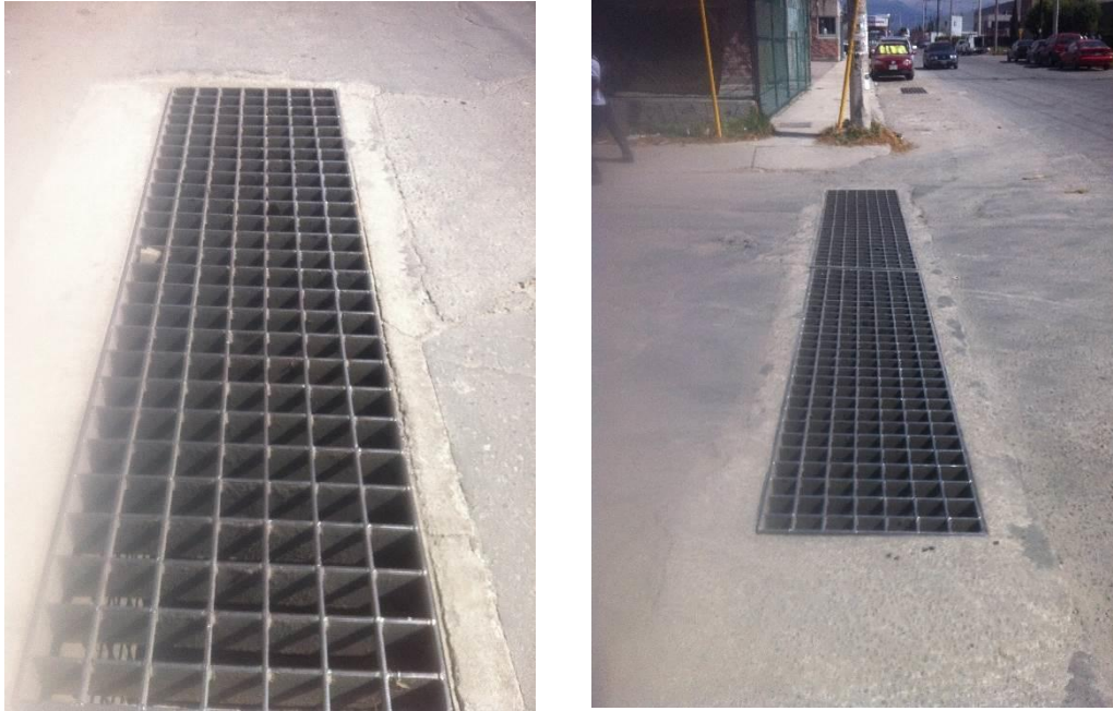
Foto 1 y 2. Drenaje Pluvial, coladera transversal
