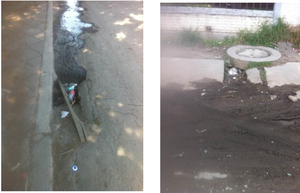
Foto 6. Drenaje pluvial y sanitario
