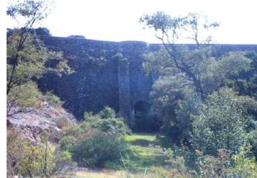
Figura 4.20. Obra de toma aguas abajo de la cortina de la Presa La Colmena
