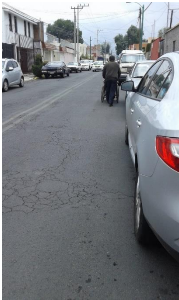
Figura 20. Presencia de obstáculos impiden a la persona transitar por la banqueta. Fuente: Ana Laura González R.
