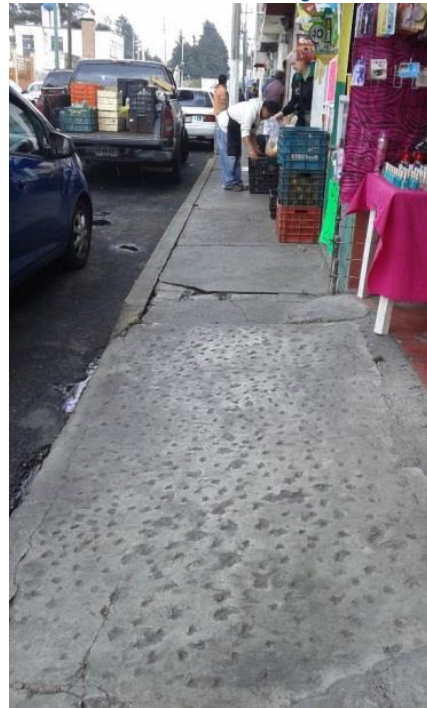
Figura 25. Rampas deterioradas y obstáculos comerciales en banqueta. Fuente: Ana Laura González Rodríguez.
