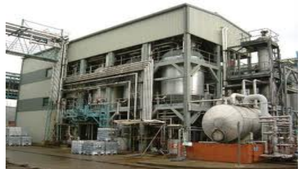
Fig. 12. Planta de Hidrogenación y sistemas de alta presión (Fuente: Knutsford Integrated Services Ltd, Manual de Servicios)
