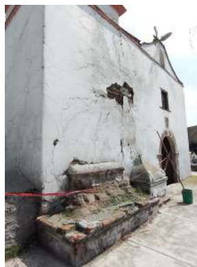
Fotografía 12 Grietas en la Fuente: Propia fachada Recuperado: 26/07/2023 principal
