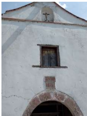
Fotografía 11 Deterioro en la madera Fuente: Propia de las ventanas Recuperado: 26/07/2023 y puertas
