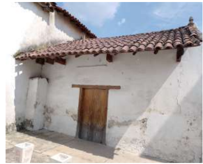
Fotografía 10 Presencia de moho y Fuente: Propia humedad en los Recuperado: 26/07/2023 muros y puertas
