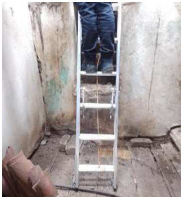
Fotografía 8 Humedad y Fuente: Propia escurrimientos Recuperado: 26/07/2023 en los muros
