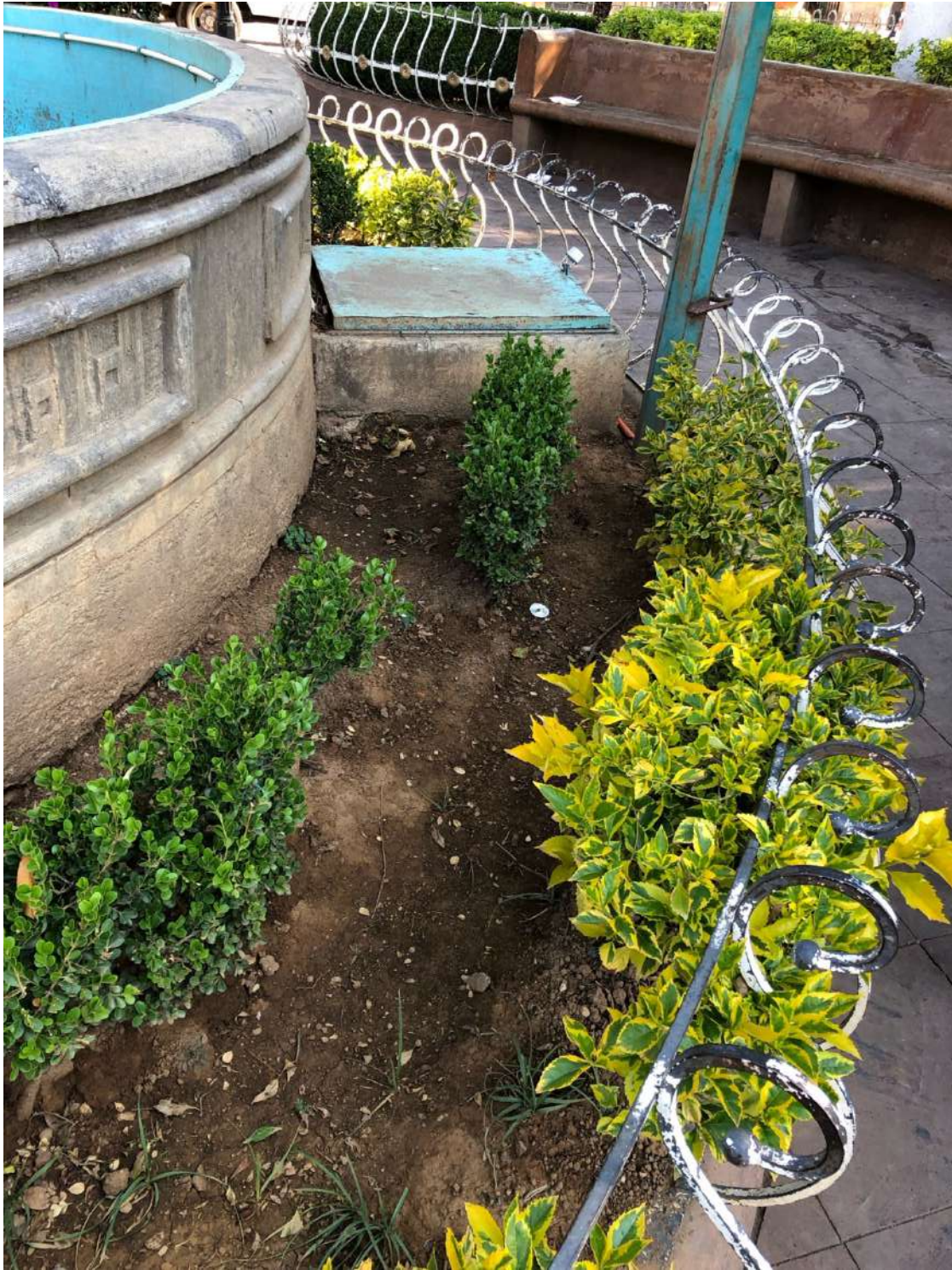
Daños en jardineras y fuente. Jardín Morelos, Tenancingo Méx. Fotografía de autoría propia.
