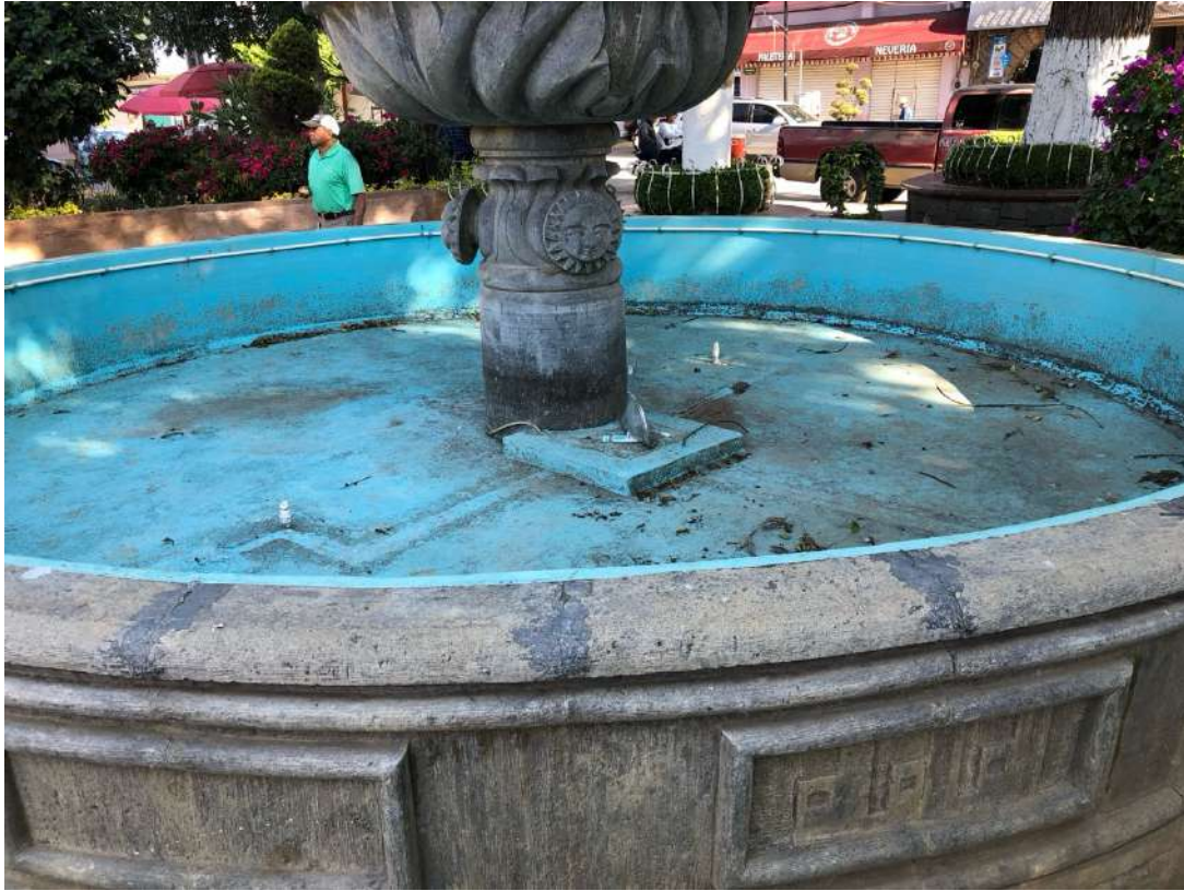
Daños en fuente. Jardín Morelos, Tenancingo Méx. Fotografía de autoría propia.
