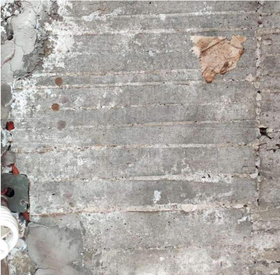
Foto 76. Techo de la casa de la señora Paula González, en donde pueden apreciarse monedas que fueron colocadas durante el colado del techo (trabajo de campo, primavera 2018).
