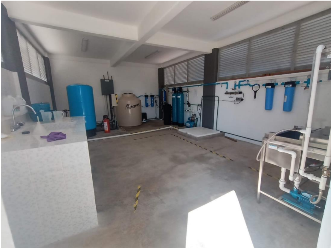
Figura 2. Planta purificadora de agua de lluvia por dentro
