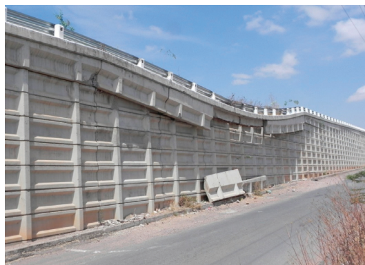
Falla estructural carretera 45, cerca de Cuauhtémoc
