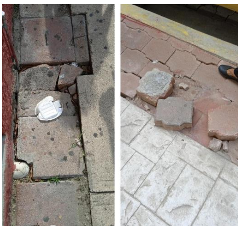
Figura 55. Fotografías de aceras en mal estado. Fuente: ICIPLAM 2022
