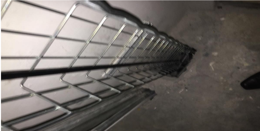
Figura 54. Cable en vertical, previo remate (Edición propia)
