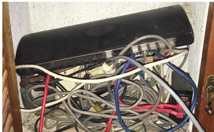
Figura 97. IDF en sala de juntas Zihuatanejo (Edición propia)
