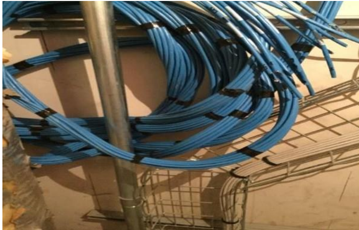
Figura 52. Cable en vertical, previo remate (Edición propia)
