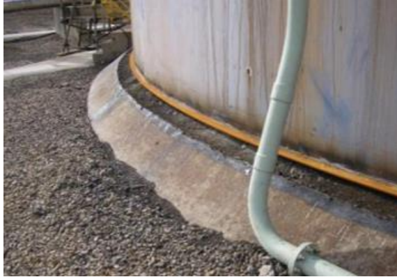
Figura 10. Corrosión en junta inferior de un tanque de almacenamiento.
