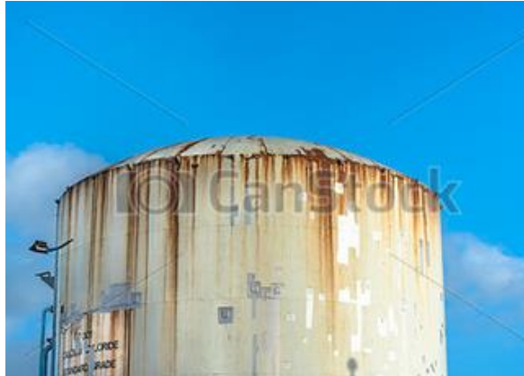
Figura 11. Exceso de corrosión entre envolvente y tapa superior de un tanque de almacenamiento.
