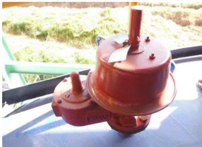
Figura 17. Válvula de seguridad (PSVDA).
