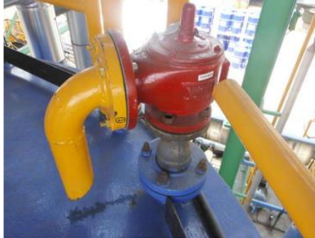
Figura 18. Válvula de Seguridad (PSV).
