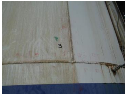
Figura 20. Tanque de almacenamiento con escurrimiento y corrosión.
