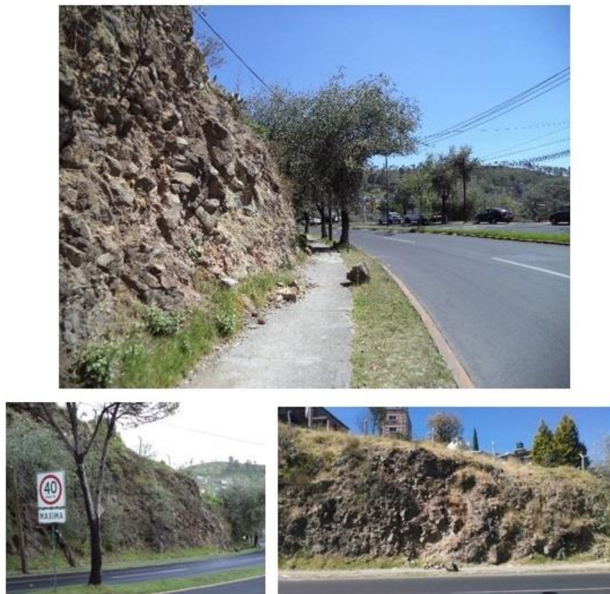
Figura 5.7. Caída de Rocas en San Miguel Apinahuizco (Vialidad Paseo Matlazincas).
