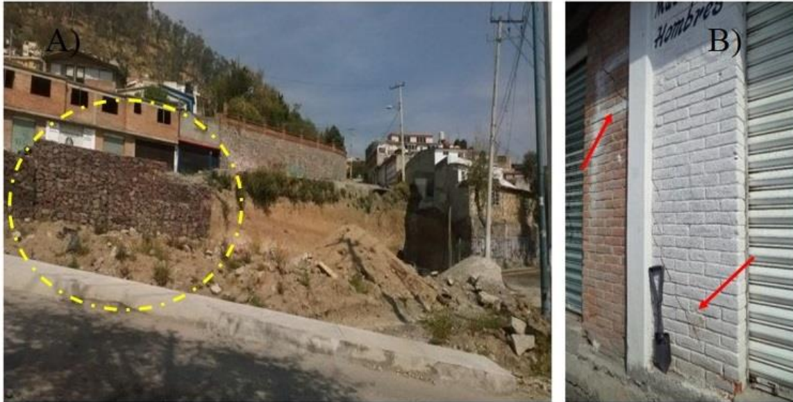
Figura 5.9. Deslizamientos ocurridos en los trabajos de movimientos de terreno para la construcción de una gasolinera en el Barrio La Teresona. A: Encerrado en el círculo amarillo aplicación de la medida estructural “Muros de gaviones” y B: Señalado por flechas rojas se muestran agrietamientos severos en las viviendas y negocios adyacentes.
