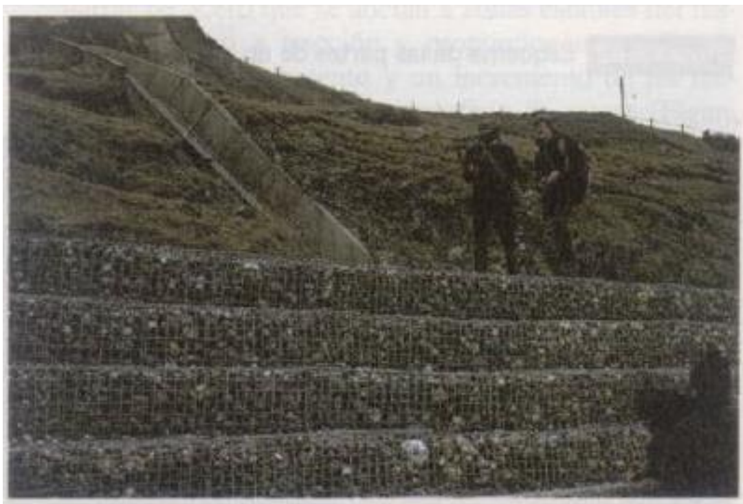
Figura 5.8. Muros de gaviones a pie de talud y cuneta de drenaje. Foto tomada de González de Vallejo (2002).
