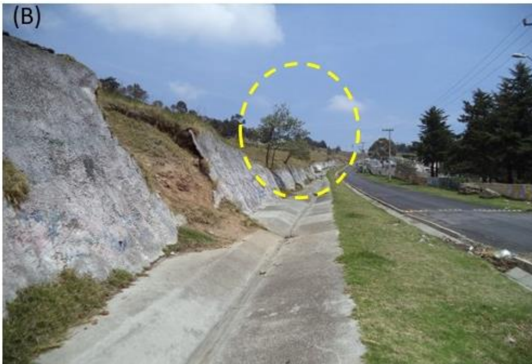
Figura 5.5. Deslizamiento sobre la calle camino viejo a Santiago Tlaxomulco (Barrio de San Miguel Apinahizco). (A): Se observan los daños sobre la infraestructura. (B) Encerrado en la línea discontinua amarilla en forma de círculo se visualizan los árboles inclinados, indicador de una ladera activa.
