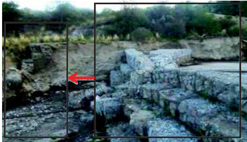
Figura 6.18. Presa de gaviones ubicada en el cauce del río Las Cruces que ha fallado debido al arrastre de material en su cimentación (socavación). Nótese que aguas abajo se identifican remanentes de una estructura similar totalmente colapsada.
