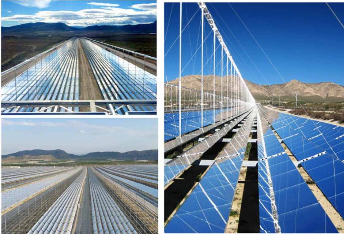
Figura 68: Reflectores lineales solares Fresnel de Novatec PE1 (Nova 1) PE2 (SuperNova) Central eléctrica
