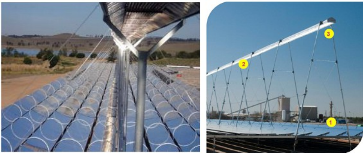
Figura 69: Reflectores lineales Fresnel de Areva Solar en Kimberlin
