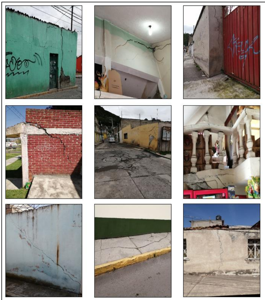
Figura 25. Casas afectadas a consecuencia de la sobreexplotación del AVT
