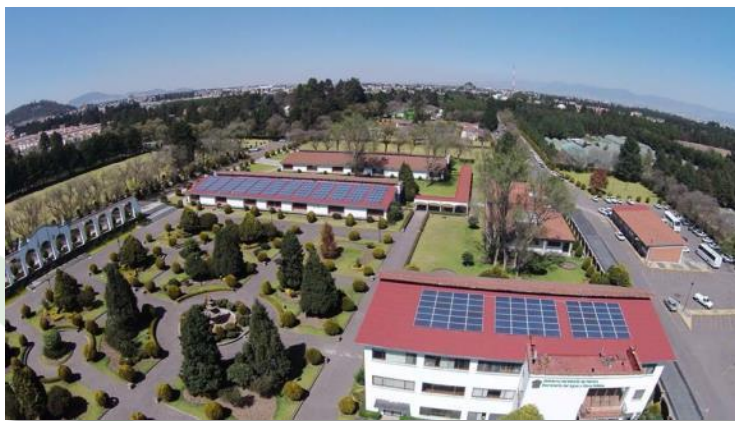
Imagen 14 Sistema Fotovoltaico instalado en el Conjunto SEDAGRO
