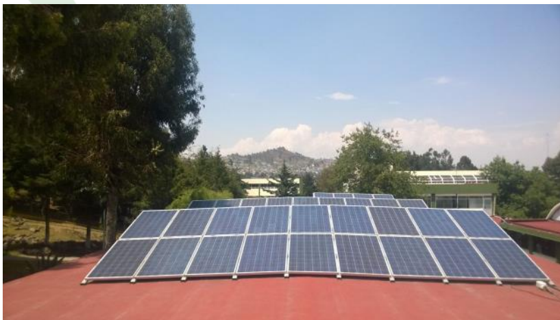
Imagen 15 Sistema Fotovoltaico instalado en el la Facultad de Ingeniería
