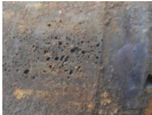
Figura 11. Demostración superficial de la corrosión por picadura (Garcia, 2016).
